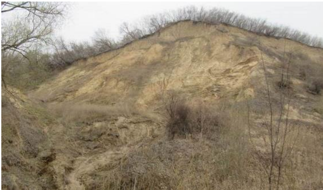
Рисунок 28. Полигенный оползень на левом береговом склоне долины р.Обь на участке ул. Квартал 953а, 380
