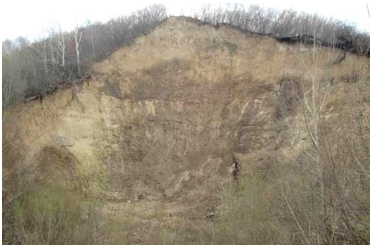
Рисунок 27. Оползневые проявления на левом береговом склоне долины р.Обь на участке ул. Квартал 953а, 481а
