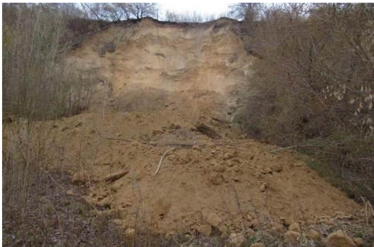
Рисунок 26. Эрозионный оползень на левом береговом склоне долины р. Оби на участке ул. Фабричная, 26
