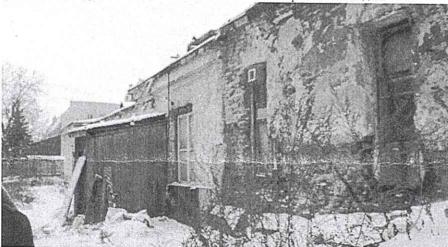
Фото 3 от 24.11.2015. Северо-восточный фасад. Поверхность стен со следами многочисленных повреждений: массовое отслоение и обрушение штукатурного слоя, до оголения кирпичной кладки; обрушение наружной версты кирпичной кладки стен; окрасочный слой здания поврежден полностью.
