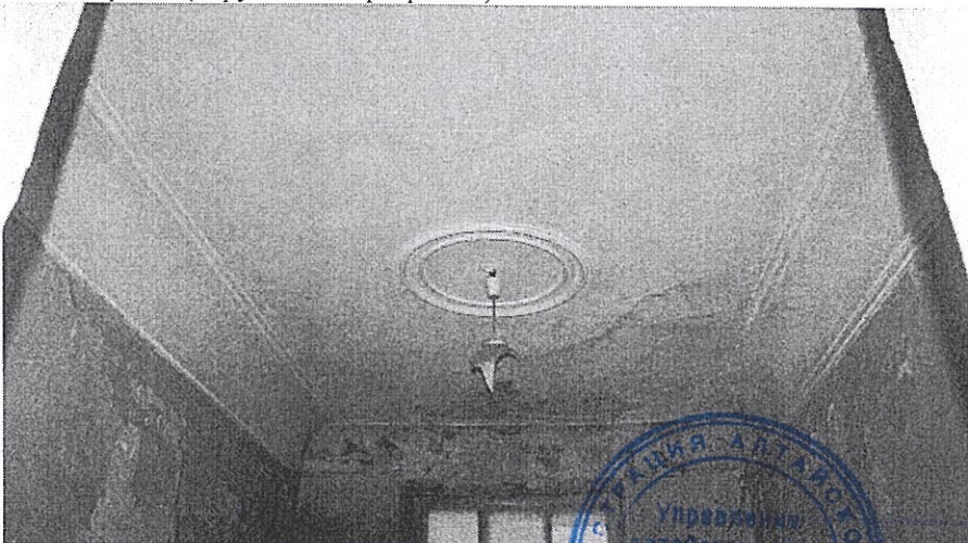
Фото 7 от 24.11.2015. В помещениях зафиксированы следы намокания и разрушения отделочного слоя перекрытий и декоративных элементов (карнизов и потолочных розеток).
