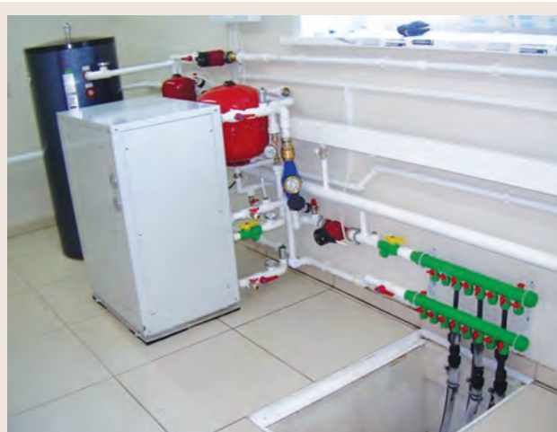
На снимке: тепловой насос, установленный в поселке Бельмесево по адресу Отечественная, 74. Площадь дома 300 м². Стоимость установки 390 тыс. рублей.
