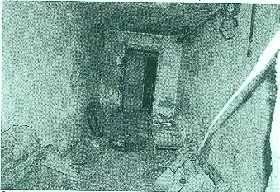
Фото 5 от 24.11.2015. Фрагмент подвального помещения – обрушение и трещины в штукатурном слое. Помещения захламлены мусором.
