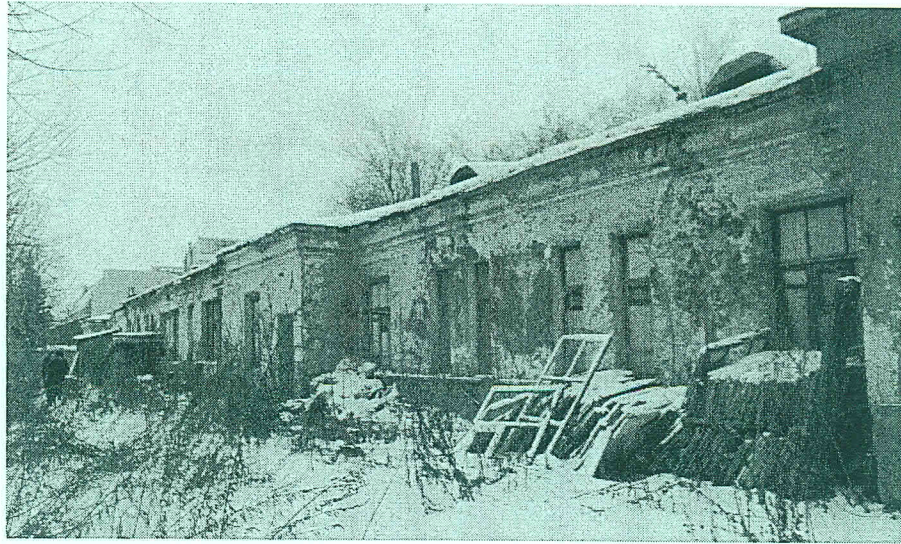
Фото 2 от 24.11.2015. Северо-восточный фасад. Поверхность стен со следами многочисленных повреждений; трещины, а также массовое отслоение и обрушение штукатурного слоя, местами до оголения кирпичной кладки.
