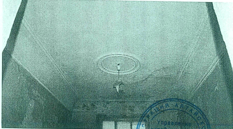
Фото 7 от 24.11.2015. В помещениях зафиксированы следы намокания и разрушения отделочного слоя перекрытий и декоративных элементов (карнизов и потолочных розеток).
