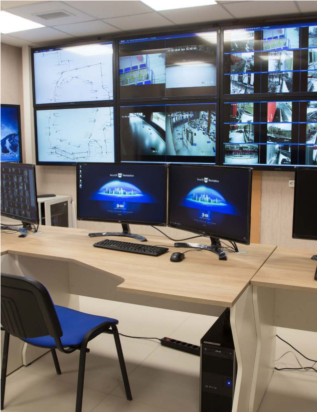
Реализация системы безопасности на стадионе «Енисей». Объект строится к Универсиаде-2019
